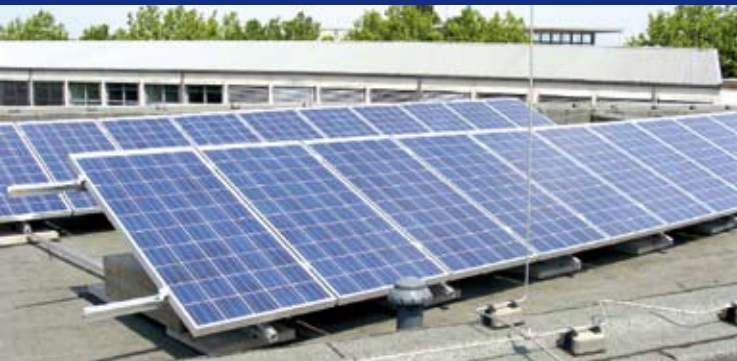
Solarstrom-Anlage Bildungspark, Essen
