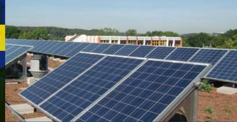
Solarstrom-Anlage Gymnasium Überrauch, Essen
