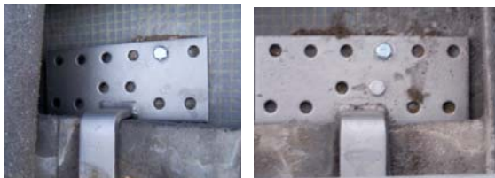
links: Dachhaken falsch montiert; rechts: richtig montiert
