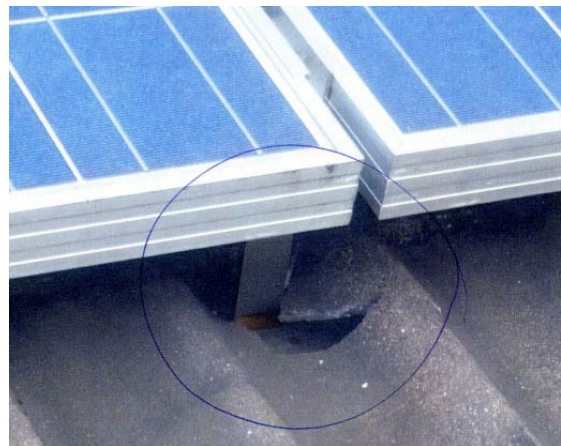
Dachstein gebrochen – Wasser dringt ins Dach ein
