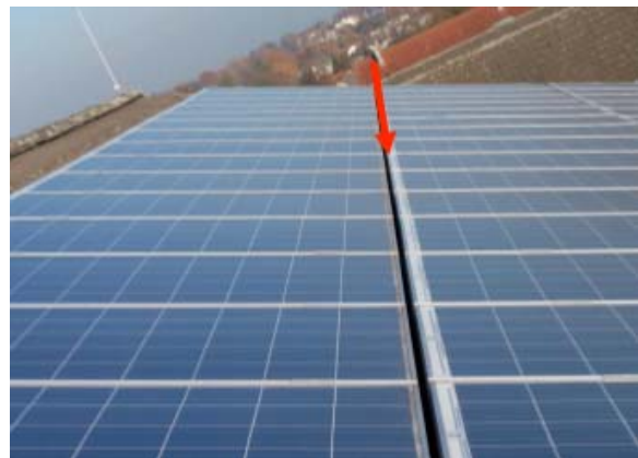
Solarmodule jetzt mit ausreichendem Fugenabstand
