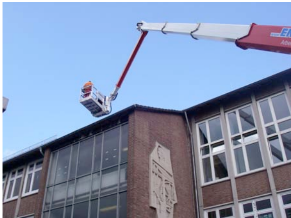
TÜV-Gutachter im Hubkran nehmen die Mängel auf
